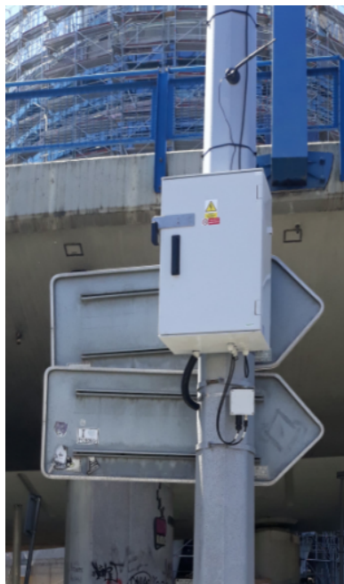
Obrázek 4. Detail umístění cyklosčítače na sloupu VO
