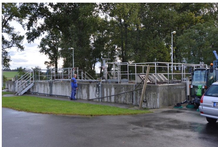
Obrázek 20. Čistírna odpadních vod
