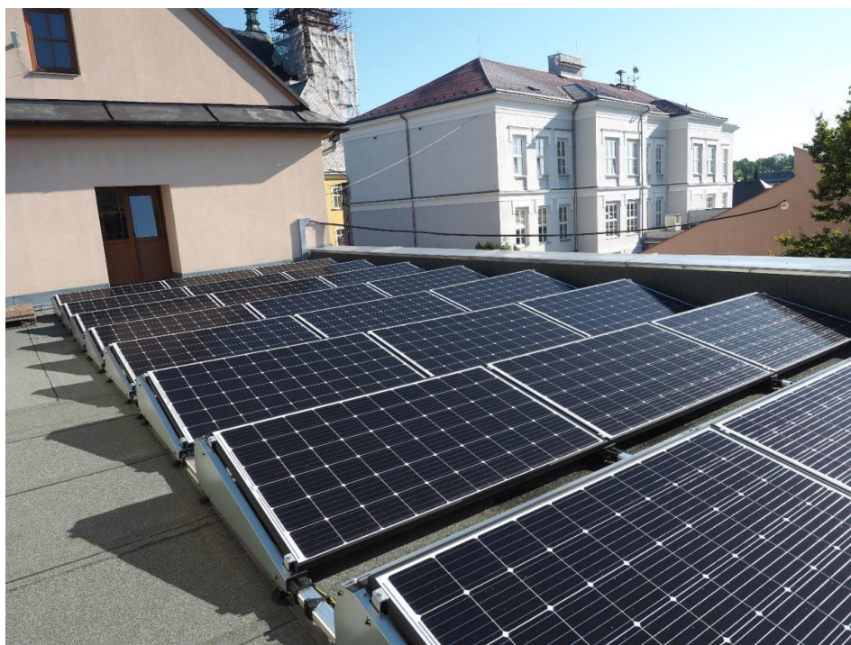
Obrázek 18. Instalované solární panely
